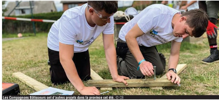
Les Compagnons Bâtisseurs ont d'autres projets dans la province cet été. © CB
